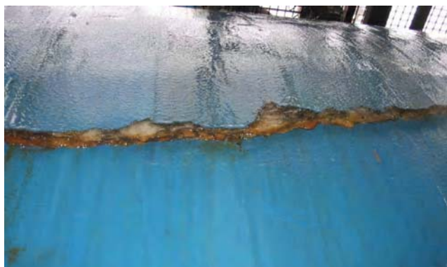
Rys. 1. Pęknięcie o długości 1,8 m powstałe w dużym zbiorniku kompozytowym [11]
